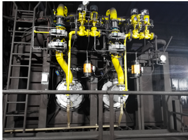
Die neuen Brenner können sowohl mit Gichtgas als auch mit Erdgas betrieben werden. Im Bild: zwei der vier neuen Brenner der Zündhaube.
